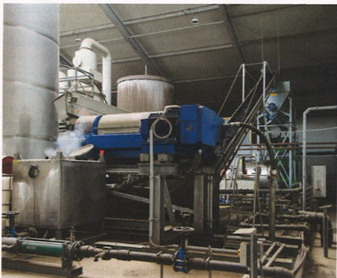
De stikstofstripper haalt ammoniumstikstof uit het digestaat.
